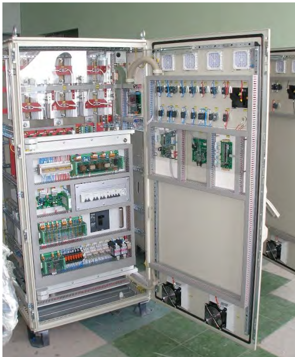
Рис. 2. Зовнішній вигляд шафи тиристорного випрямляча у складі СВГ
