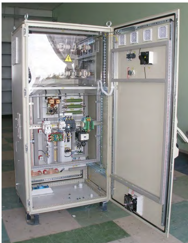
Рис. 3. Зовнішній вигляд шафи комутації та захисту
